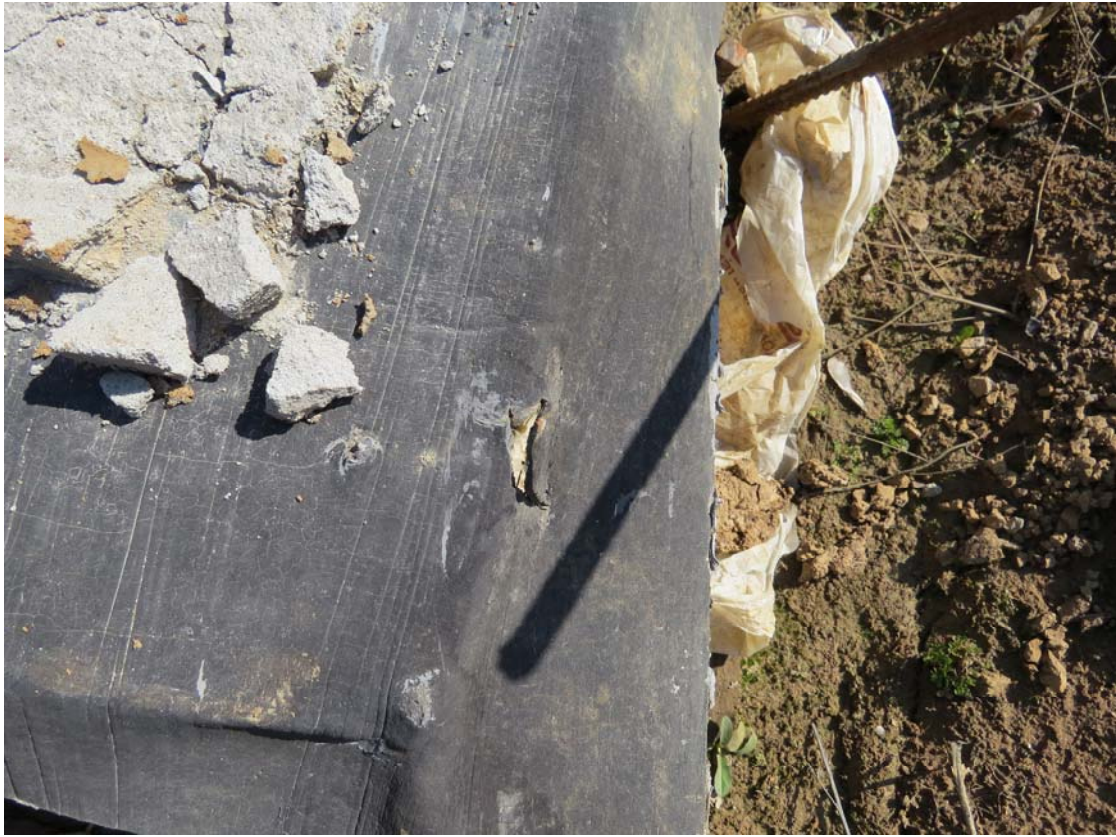
Рис. 3.9. Повреждение горизонтальной гидроизоляции фундаментной плиты корпуса №12.1
