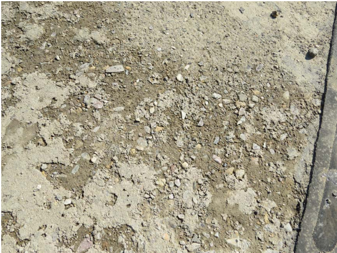
Рис. 3.10. Растрескивание и разрушение защитной цементно-песчаной стяжки поверх горизонтальной гидроизоляции фундаментной плиты корпуса №12.1
